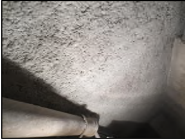
Photo N° 32 ECH-N°1 FLOCAGE PREHAUT_RDC Plafonds COTONNEUX BLANC
